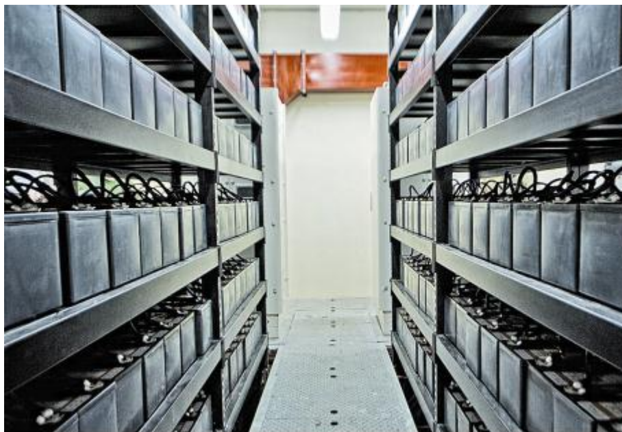
Рисунок 2. Большое поле аккумуляторов — неотъемлемый элемент системы бесперебойного питания, построенной на основе статических ИБП.
