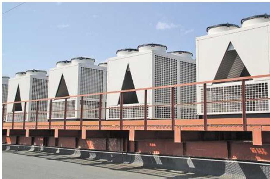
Рисунок 1. Относительно высокая энергоэффективность ЦОД стала возможна благодаря установке системы охлаждения с режимом естественного охлаждения (фрикулинг). Данный режим реализуется с помощью установленных на крыше сухих градирен (драйкулеров), которые «помогают» чиллерам охлаждать смесь пропиленгликоля с водой.
