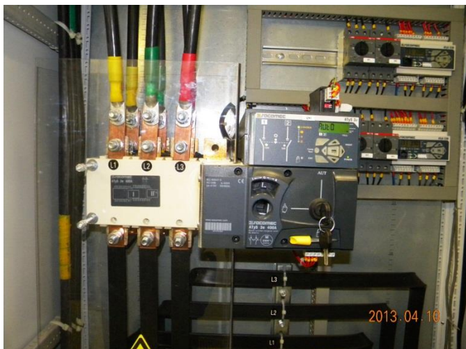
Рис. 9. Шкаф автоматики ввода резерва (система электроснабжения).
