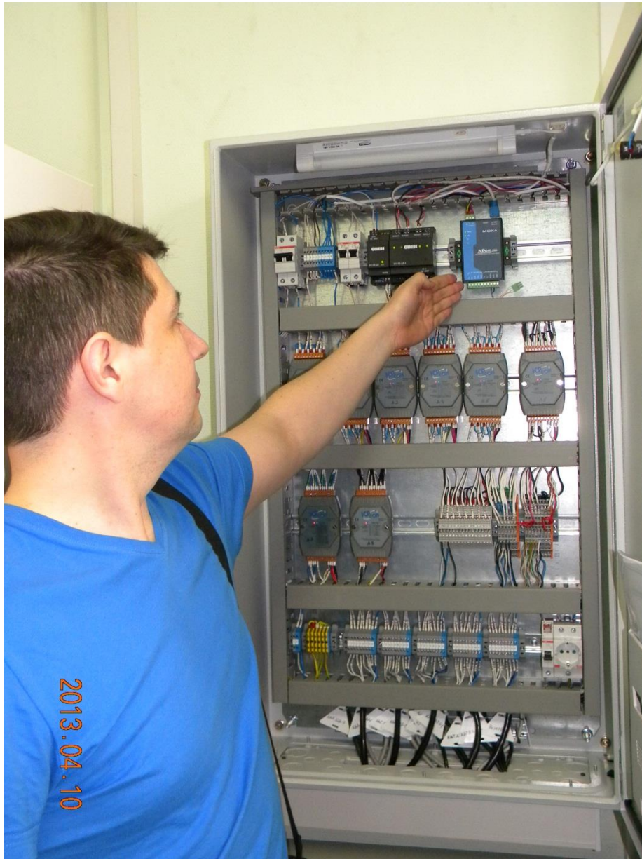
Рис. 8. Руководитель проекта со стороны ООО «ИнСАТ» А.В.Серебряков – промежуточная сдача работ: шкаф автоматики.
